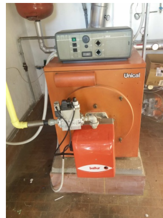
Figura 8.5 – Sistema di generazione obsoleto da sostituire
