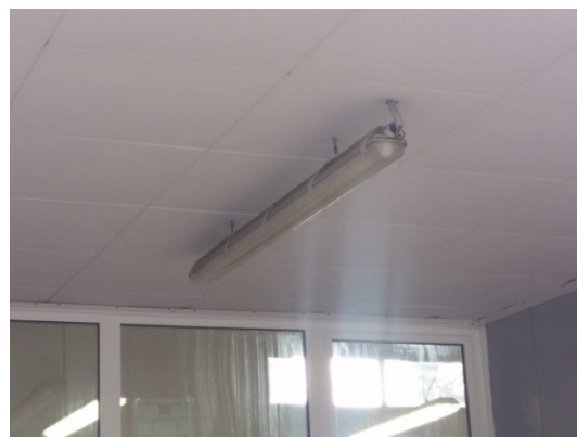
Figura 4.12 - Particolare dei corpi illuminanti ubicati nelle aule
