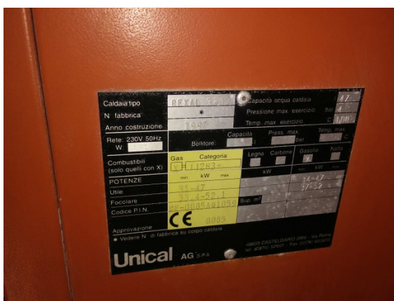
Figura 4.9 - Generatore di calore – UNICAL REXTAL 3-47
