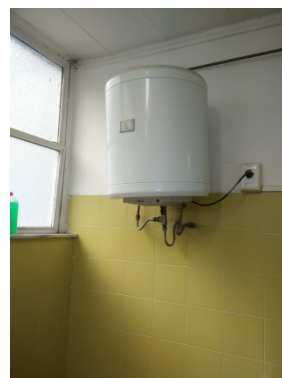
Figura 4.11 – Particolare bollitore elettrico.
